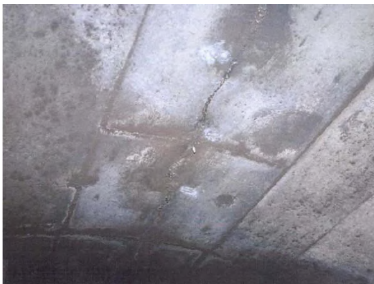
شکل ۳۷-۴ وقوع پدید ترک خوردگی در سقف تونل
