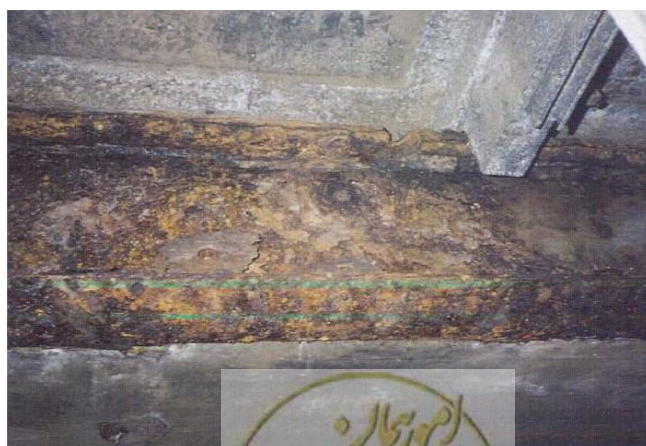
شکل ۱-۶۳ خوردگی تیر فولادی در سقف سازه
