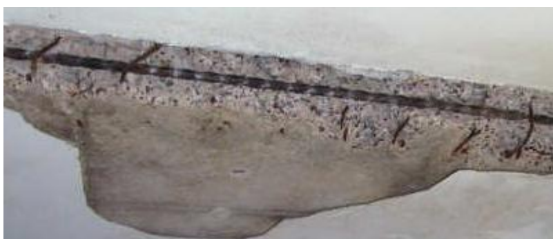
شکل ۳۹- ریزش بتن در اثر پدیده پوسته‌شدگی
