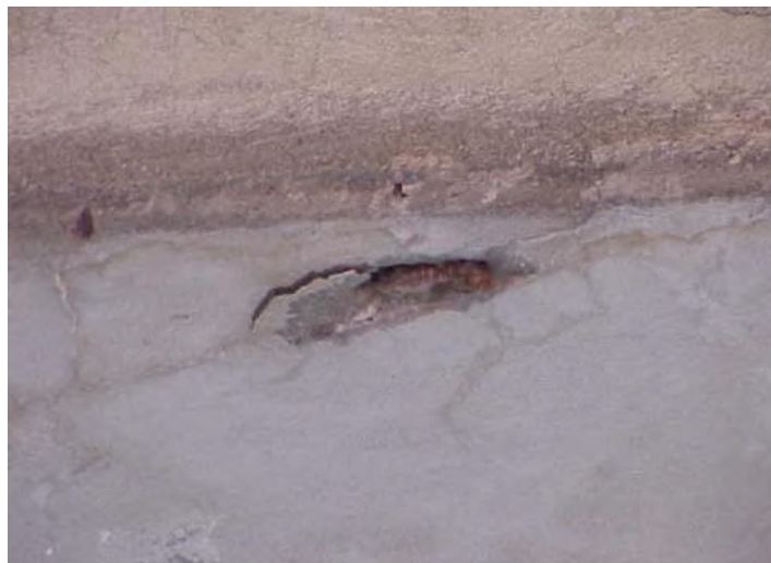
شکل ۴۰- پدیده قلوه‌کن شدن بتن
