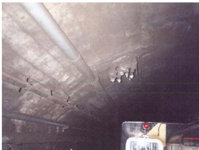
شکل ۴۳→ ریزش سقف تونل به دلیل نشت آب
