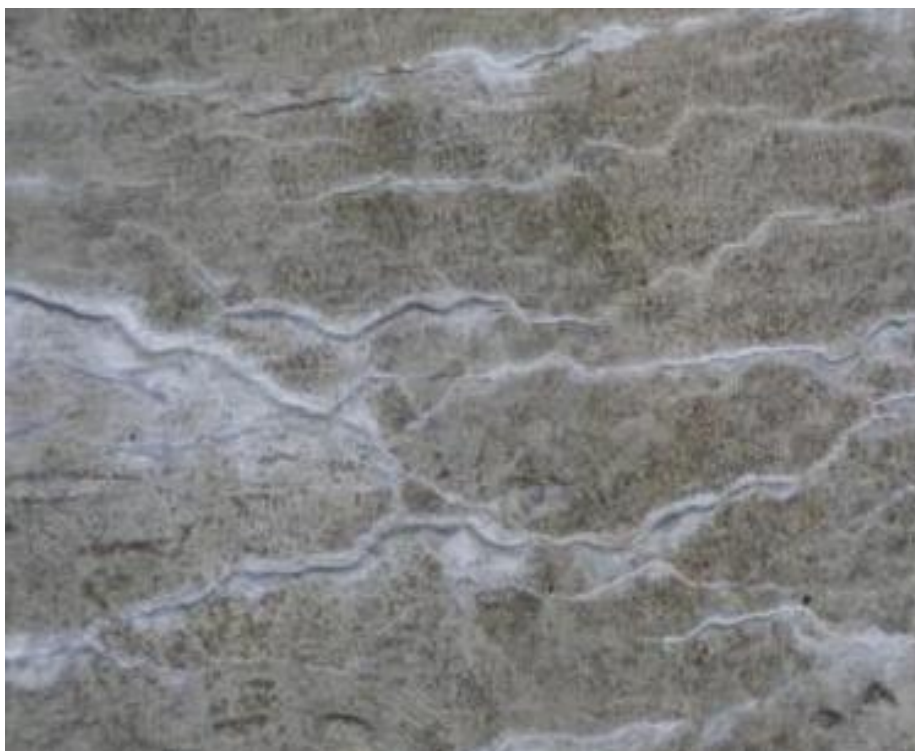
شکل ۴۱-۳ شوره زدگی بتن
