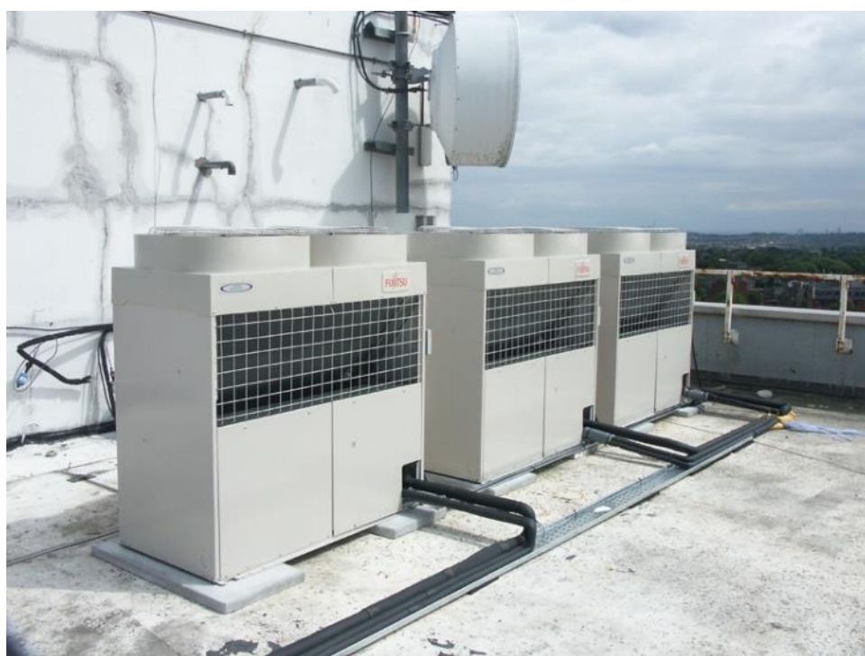
شکل ۴-۱ نمای کندانسینگ یونیت خارجی سیستم VRF
