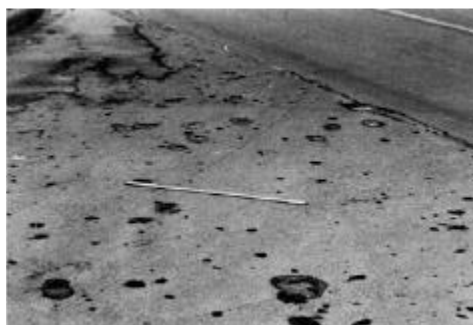
شکل ۲-۳۵ بیرون پریدگی روسازی بتنی
